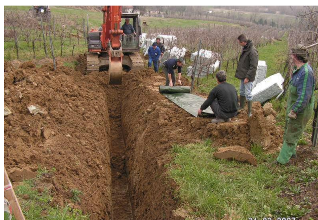
▲ Lavori nella zona a vigna con posa delle trincee GABBIODREN® all'interno dei filari
