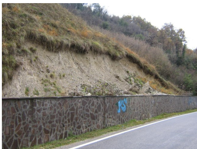
▲ Situazione di degrado prima dei lavori
