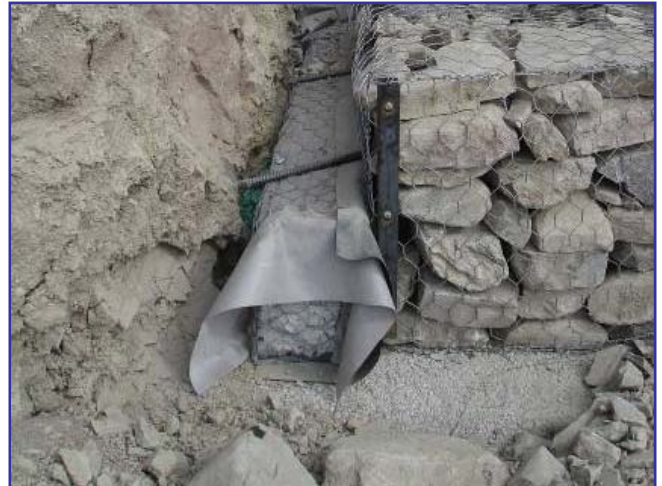
▲ Dettaglio del drenaggio Gabbiodren™
