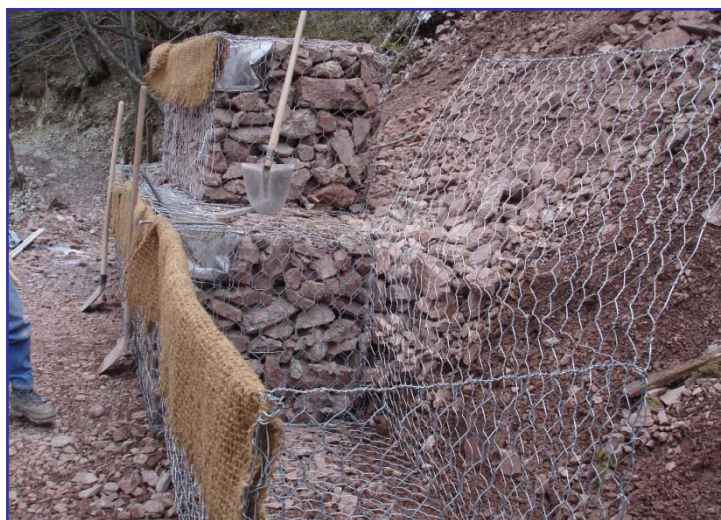
▲ Fasi di assemblaggio e riempimento dei gabbioni a sostegno della pendice detritica
