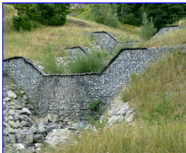
Foto 3 – Serie di briglie trasversali in gabbioni sul torrente Guadarolo – Ligonchio (RE). Si noti la protezione della gaveta con rivestimento in tondo di legname.
