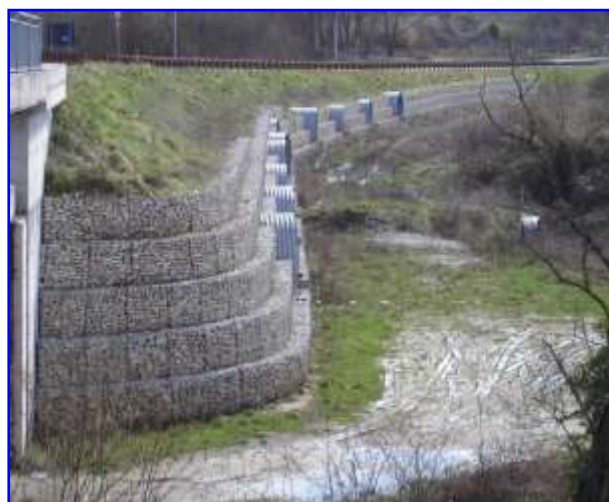
Foto 2 – Opera di contenimento e protezione idraulica di un rilevato di approccio ad un attraversamento sul Fiume Aniene.
