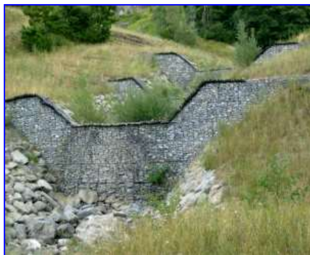
Foto 3 – Serie di briglie trasversali in gabbioni sul torrente Guadarolo – Ligonchio (RE). Si noti la protezione della gaveta con rivestimento in tondo di legname.
