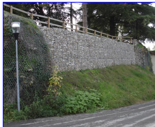
Foto. 1 - Opera realizzata con Nail-Gabions con chiodatura del corso centrale di gabbioni con barre B450C di lunghezza 5 metri e diametro 32mm con testa filettata
