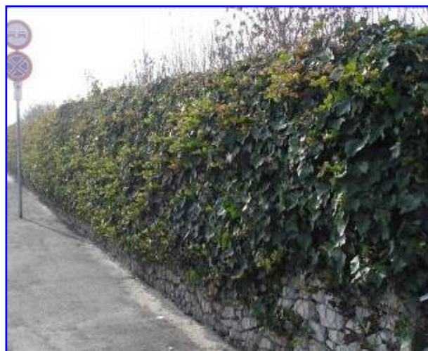
Foto 1 - Barriera fonoassorbente realizzata con gabbioni rinverdibili e piantumazioni di essenze rampicanti
