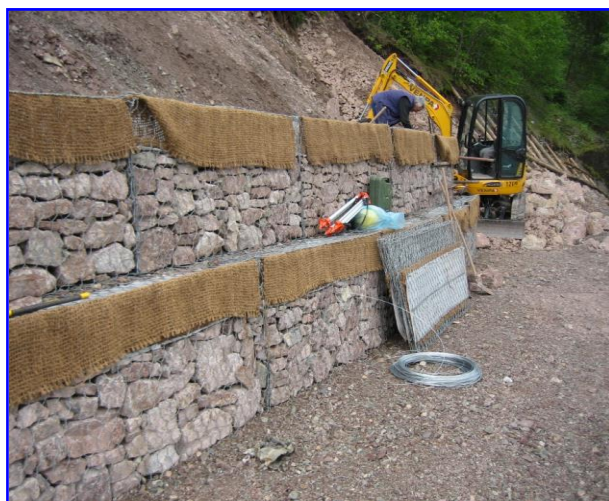
Foto 1 – Operazioni di posa e assemblaggio di Gabbioni Verdi nel consolidamento e drenaggio di una pendice detritica
