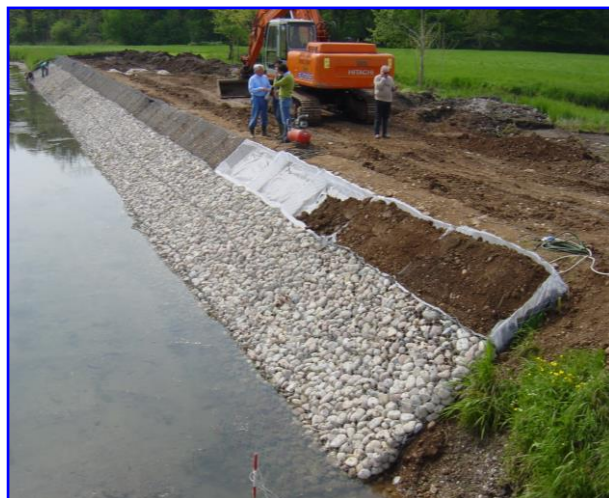
Foto 1 – Fasi di posa in opera del Materasso MATECO®, riempimento differenziato delle tasche con pietrame e con terreno vegetale
