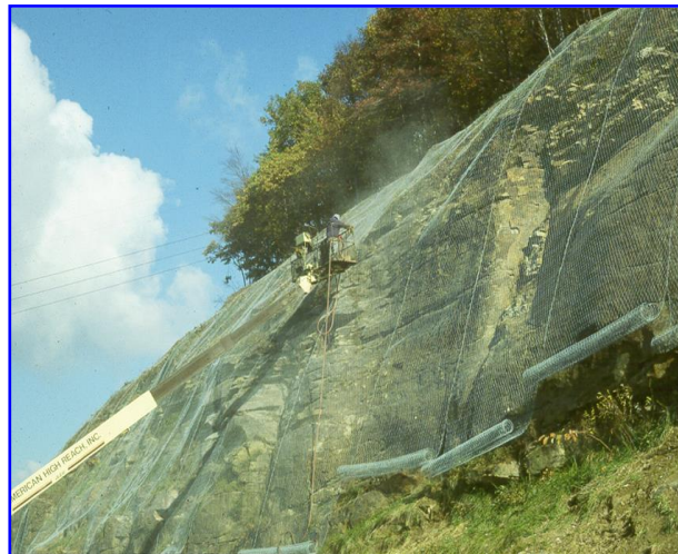
Foto 1 - Installazione di un intervento paramassi in parete, legatura dei teli di rete a doppia torsione
