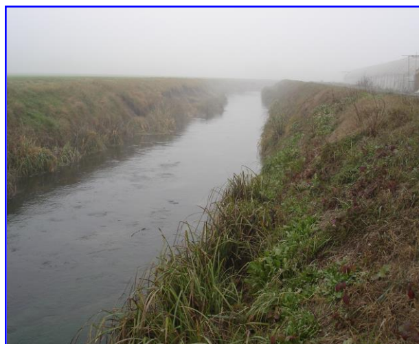
Foto 4 - Situazione del canale prima dell'intervento
