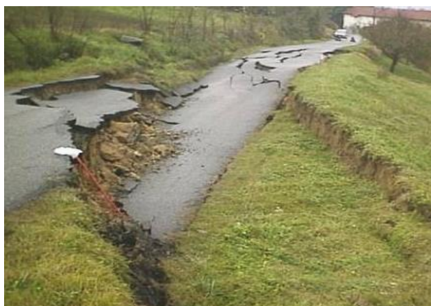
▲ Condizione del dissesto (Novembre 2002)
