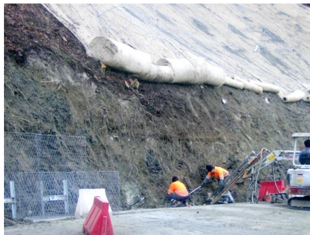
▲ Consolidamento del piede della scarpata con gabbioni chiodati e protezione dall'erosione con FAST-TER®
