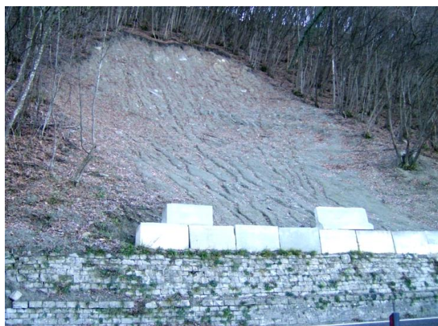
▲ Situazione del dissesto prima dell'intervento
