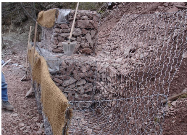
▲ Fasi di assemblaggio e riempimento dei GABBIONI VERDI a sostegno della pendice detritica
